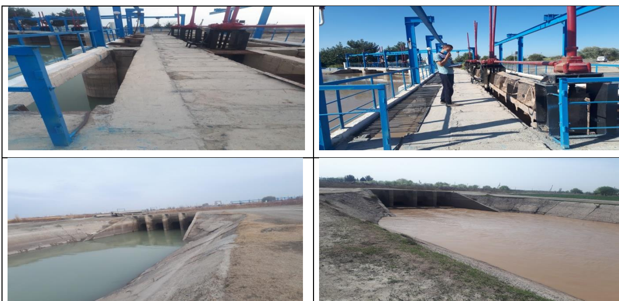
3-rasm. Hidrouzeldagi pazlarning shandorlar bilan jihozlanmaganligi zatvorlarning korroziyaga qarshi ishlov berilmaganlik holati.
